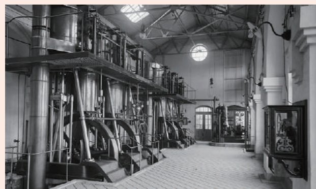
操作當時的遠賀川水源地泵浦室蒸汽泵浦
